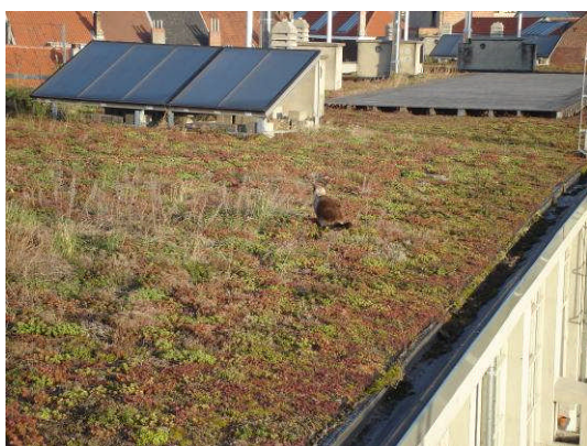
Panneaux solaires et toiture végétalisée, duo gagnant pour la gestion de l'énergie du bâtiment. Photo IEB Sabine Vanderlinden
