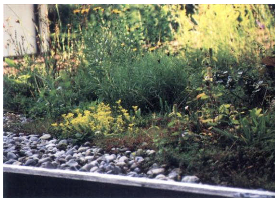
Graviers roulés en bordure du toit pour assurer le drainage. Photo extraite du livre « Végétalisation des toitures », Edition Ulmer. Brigitte Kleinod
