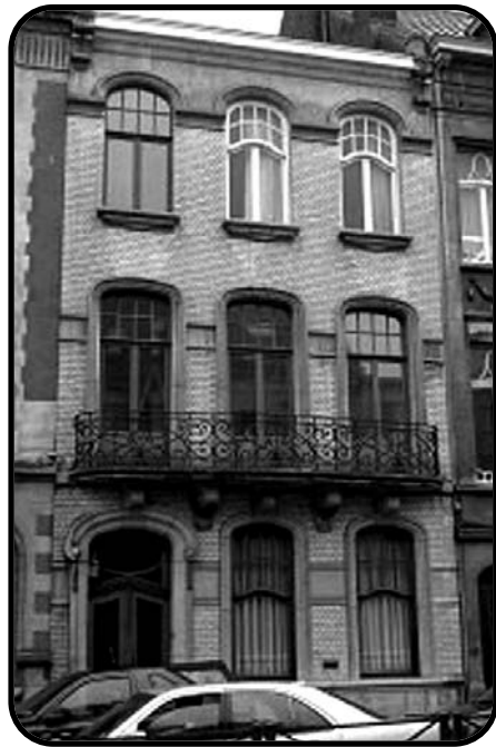
Le 1 er octobre, l'ARAU a constaté, au boulevard Belgica n° 12, le changement de châssis avec de fortes modifications du dessin d'origine.
