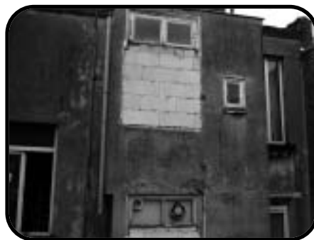
Travaux de faible qualité et illégaux.
